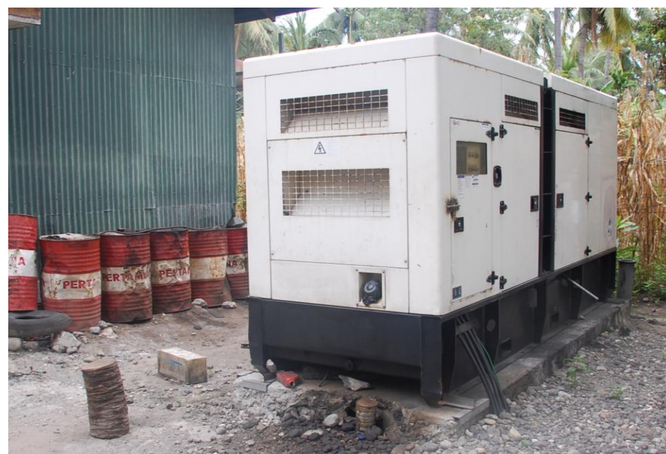
Figura a27.2: vista do gerador diesel principal. Fonte: Dalan, 2015.
