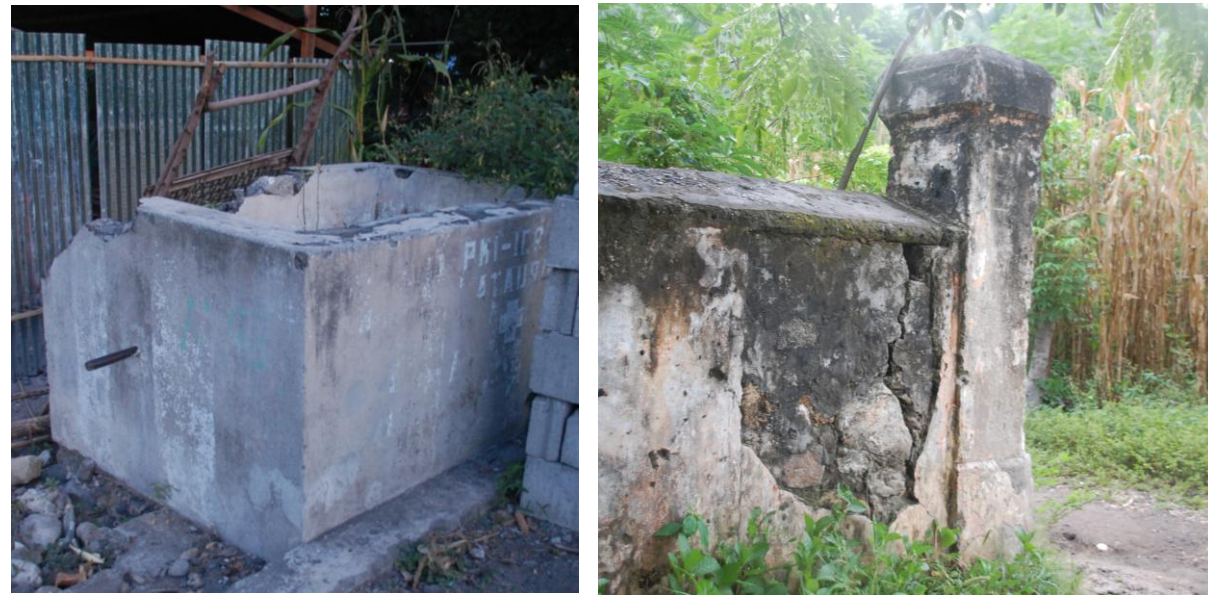
Figuras a44.1 e a44.2: abandono e desvalorização do património português na ilha de Ataúro, designadamente: do antigo tanque da Cruz vermelha, e; do muro da Residência do Administrador da Antiga Colónia Portuguesa de Timor (Casa do Administrador)
