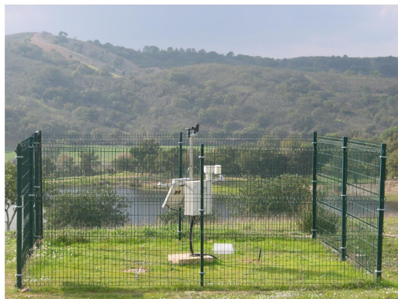
Figura a1.1 – vista de uma Estação Meteorológica Automática.
