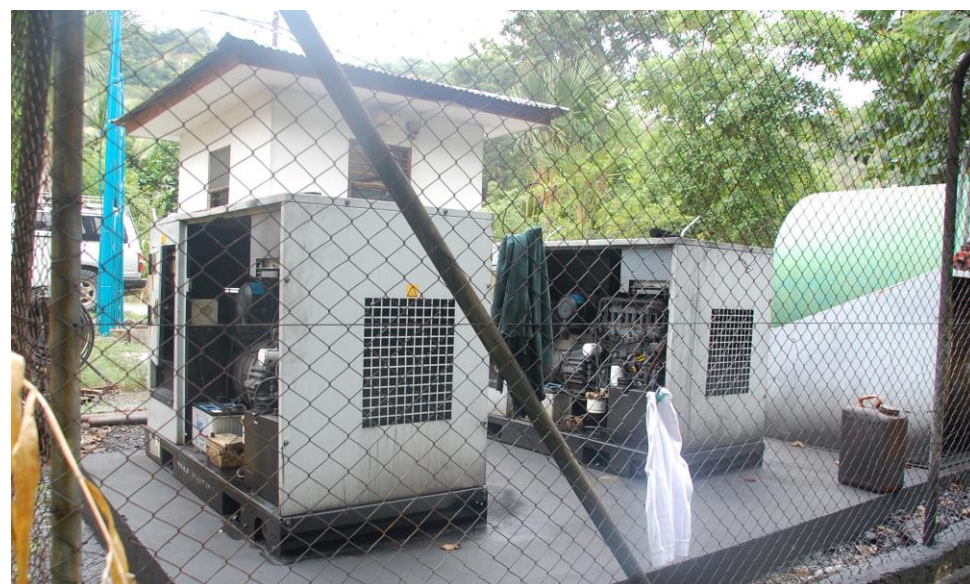
Figura a27.1: vista grupos geradores diesel junto aos edifícios administrativos. Fonte: Dalan, 2015.
